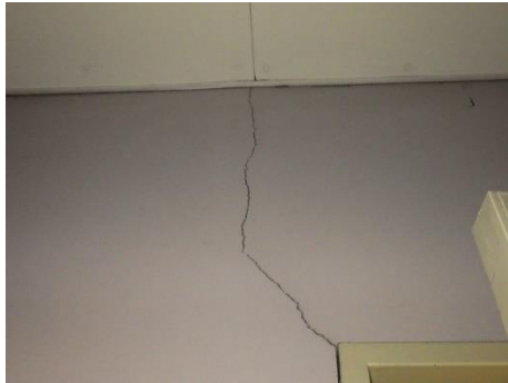
壁のひびわれ
