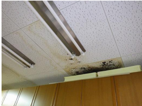
天井の漏水跡
