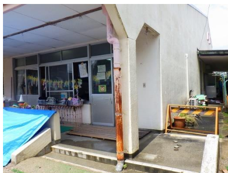
排水管の腐食
