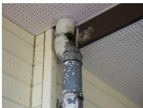
排水管の腐食
