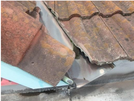
屋根葺材の劣化
