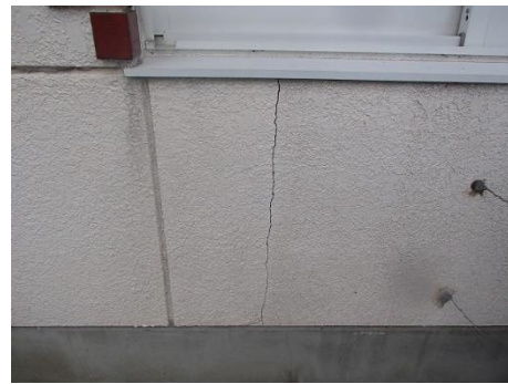
壁のひびわれ
