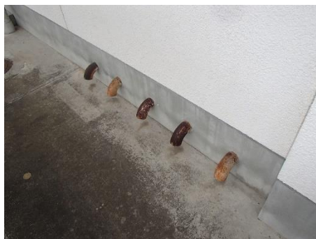
排水管の腐食
