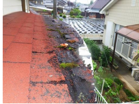
屋根葺材の劣化
