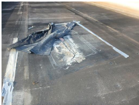
防水シートの破損
