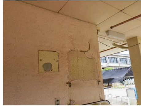
外壁劣化、塗膜剥離
