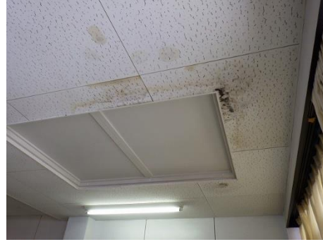
天井の漏水跡
