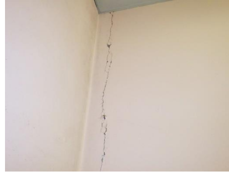
壁のひびわれ
